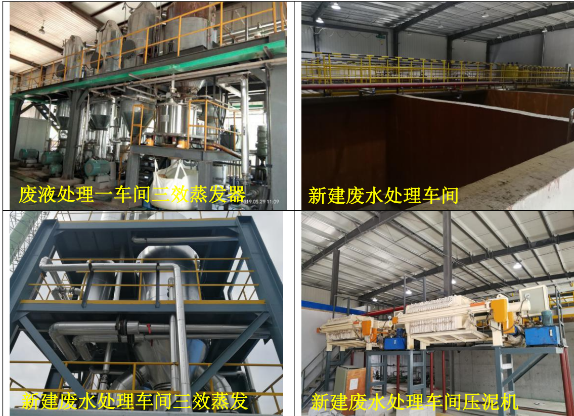
图 3-1 污水处理车间现场照片
