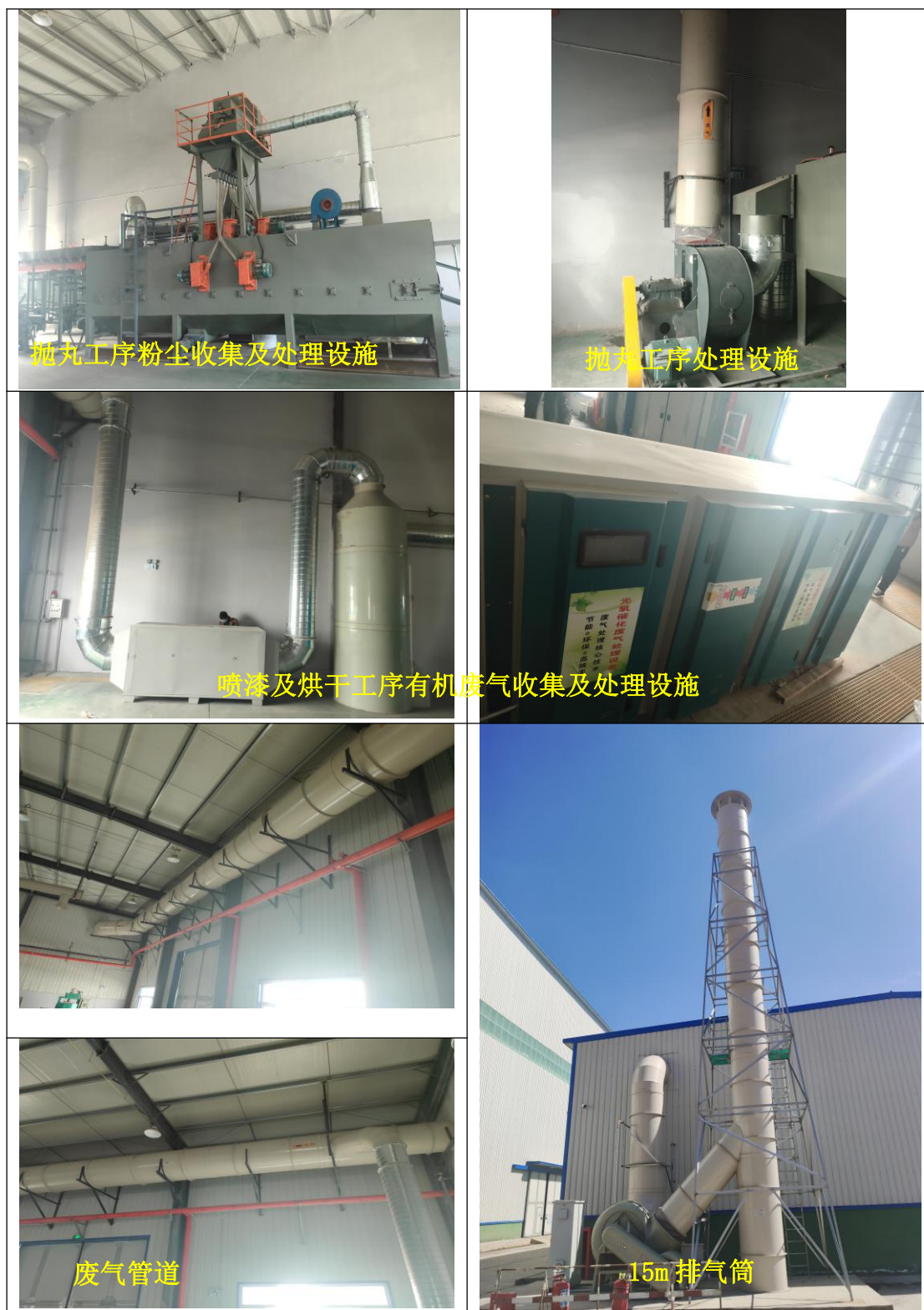
图 3-7 废包装容器清洗车间废气污染防治措施现场照片
