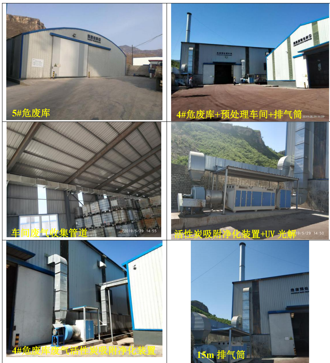
图 3-4 危险废物贮存废气污染防治措施现场照片
